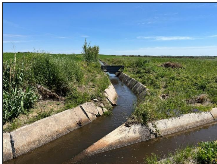
Figura 6 – Encontro do canal direito e esquerdo, com degradação das espaldas.
