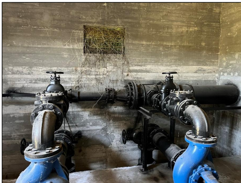
Figura 8 – Vista interior da estação elevatória da margem esquerda.
